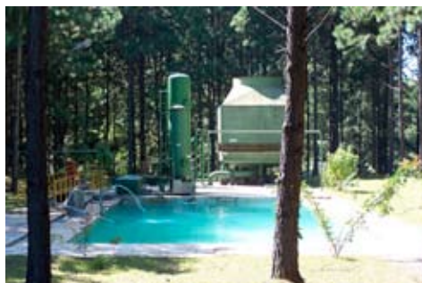
Estação de Tratamento de água industrial
